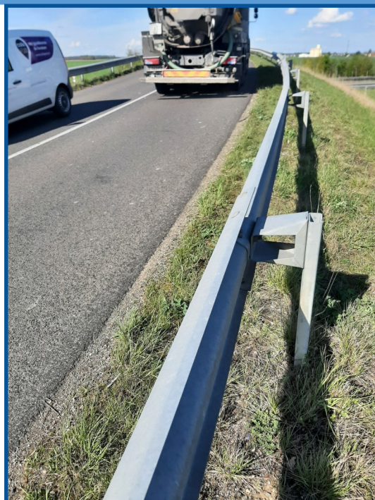
RD 45 : franchissement dangereux de l'A85
