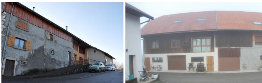
Traitement des façades et des menuiseries qui ne respectent pas la modénature d'origine et l'homogénéité du bâti
