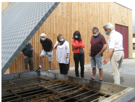
La chaufferie biomasse
