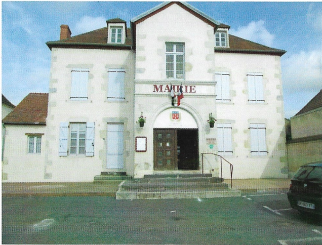
↳ Dans son ancienne configuration, l'accessibilité à la mairie laissait à désirer.
