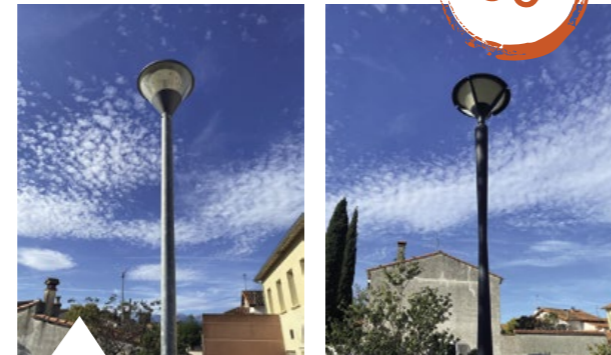
Eclairage Leds au parking du Foyer municipal.
