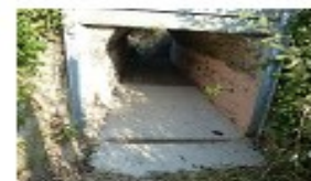
Site de stockage de la Gauteraie à Brain sur Longuenée : rejointement des murs du perthuis
